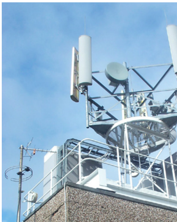
Figura 10.1 — Antenne settoriali della telefonia mobile e antenna parabolica a microonde sul tetto del vano ascensore
