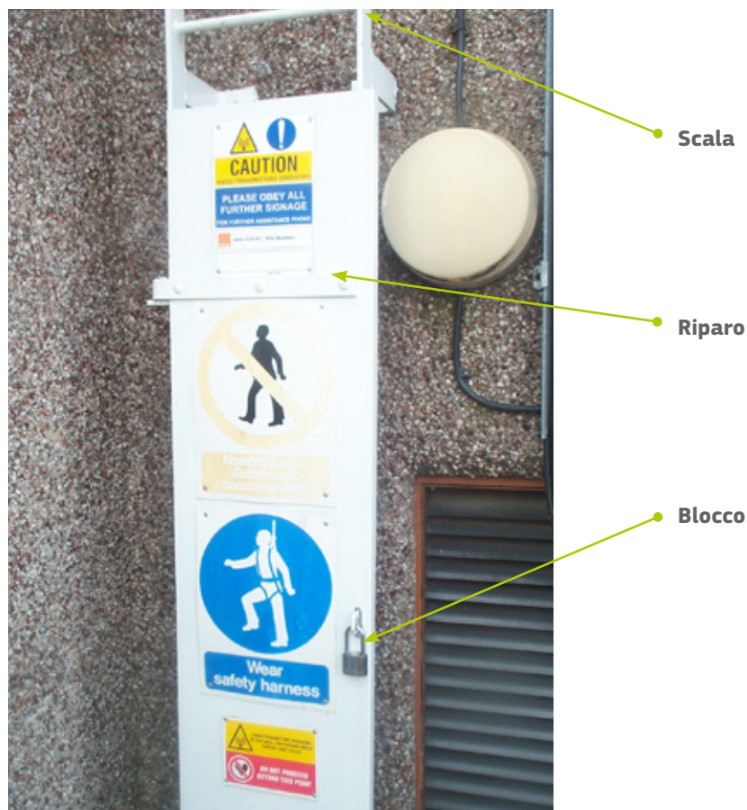
Figura 9.2 — Utilizzo di un riparo per scale, allo scopo di limitare l'accesso a forti campi elettromagnetici su un tetto
